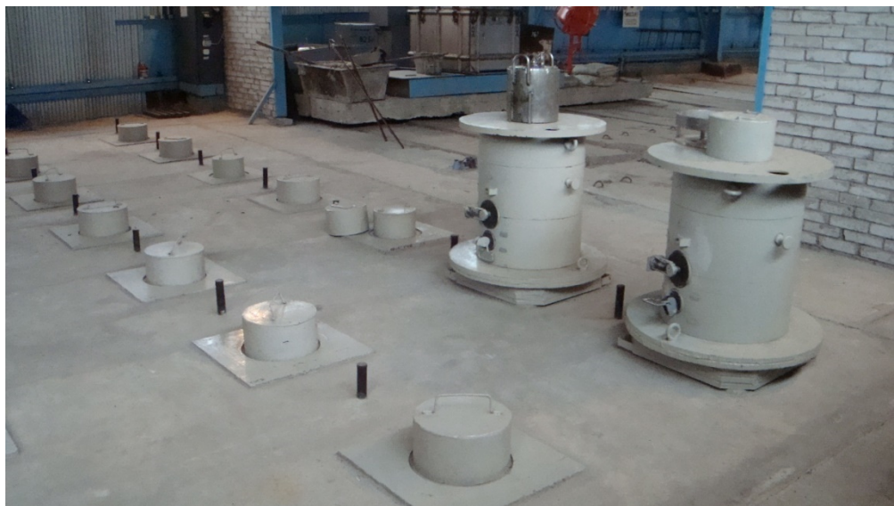
Рисунок 2.2.3.4 – Участок бесконтейнерного хранения ИИИ
