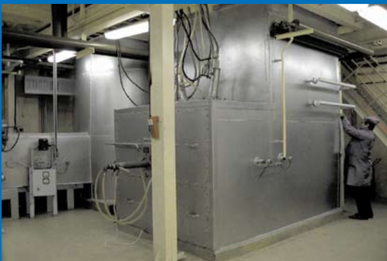
Опытно-промышленная установка плазменной переработки радиоактивных отходов «Плутон»
